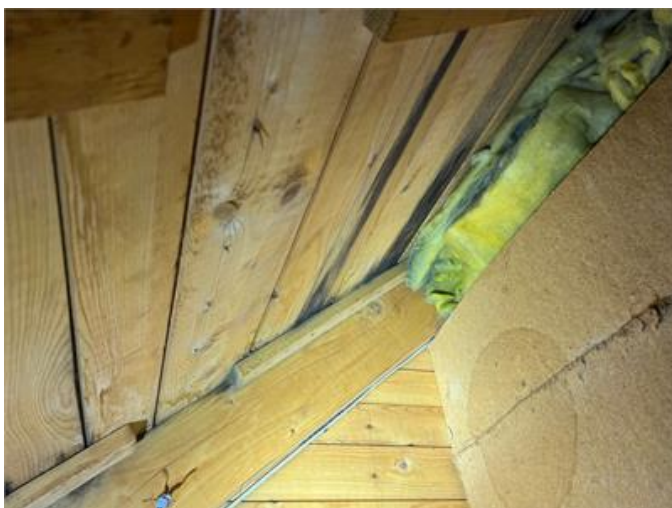
Exempel på fuktfläckar/missfärgningar (torra vid besiktning) i underlagstak i vindsutrymme.
