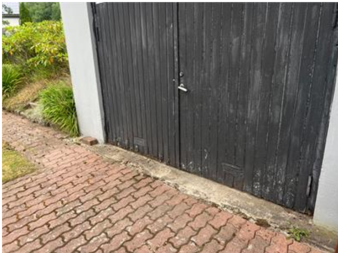
Rötskador i garageportar.
