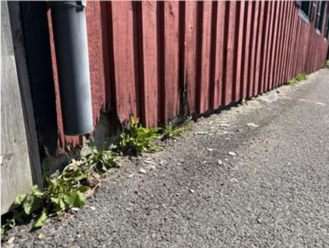
Rötskador fasad, takavlopp bör ledas bort från huset.
