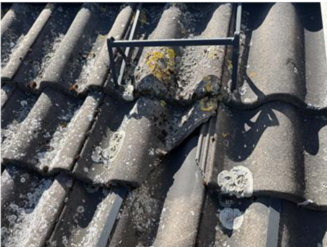
Skadade takpannor yttertak rekommenderas att bytas ut.
