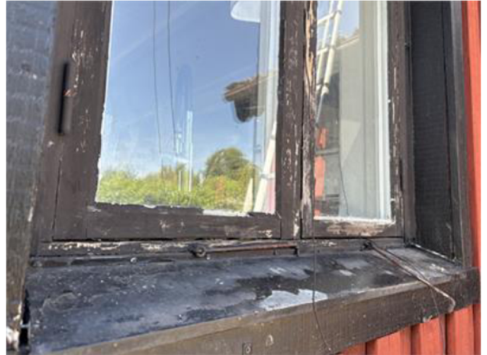
Fönsterpartier med åtgärdsbehov.
