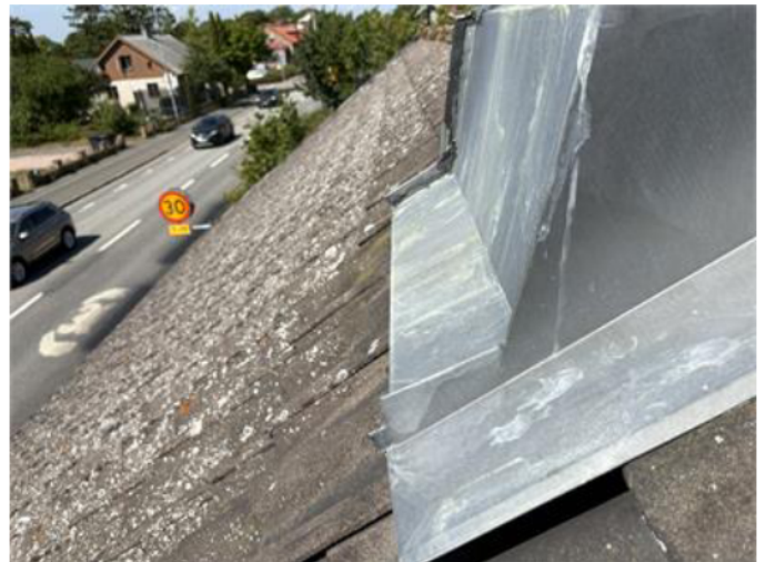
Takpannor vid skorsten har glidit ner. Pannor lades delvis tillräta vid besiktningen men är inte fixerade.
