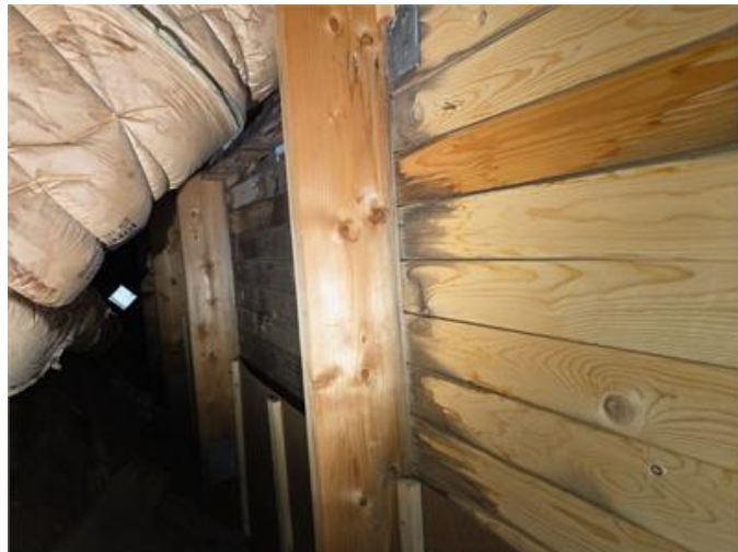
Läckage i yttertak
