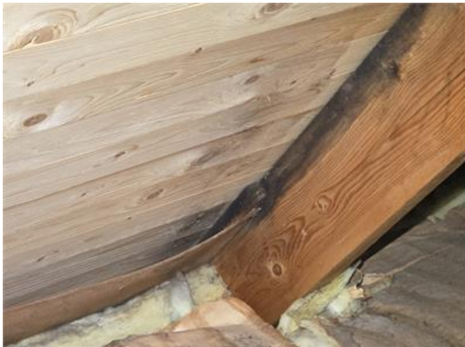
Mikrobiell påväxt på underlagstak.
