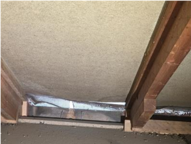
Fuktfläckar på underlagstak.
