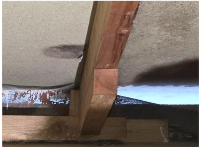
Fuktfläckar på underlagstak.
