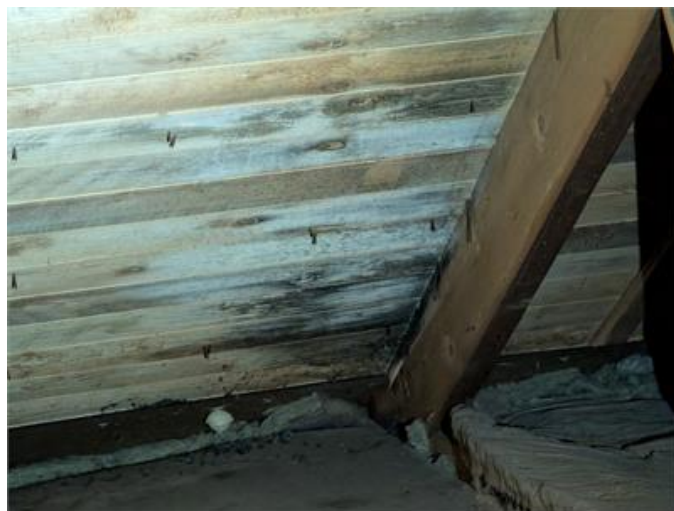
Det förekommer spår av fuktrinträngning och mikrobiell tillväxt på flera platser.
