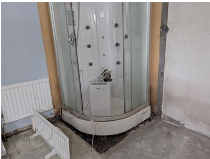
Yta bakom och under duschkabin är ej besiktningsbar, dock noterades läckage från vattenledning samt mikrobiell tillväxt.
