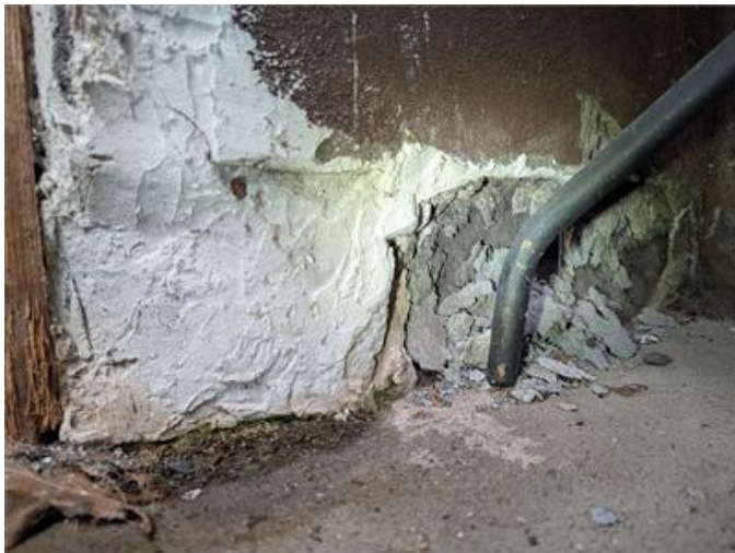
Del av sockel som bör åtgärdas.
