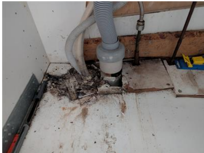
Spår efter läckage förekommer i diskbänkskåp, vilket bör kontrolleras och åtgärdas.
