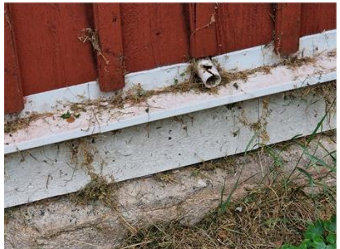
Fasad: Plaströr mynnar genom fasad. Fuktion oklar.
