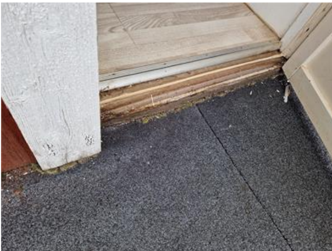
Fönster och Dörrar: Rötskador noterats i tröskel under balkongdörr
