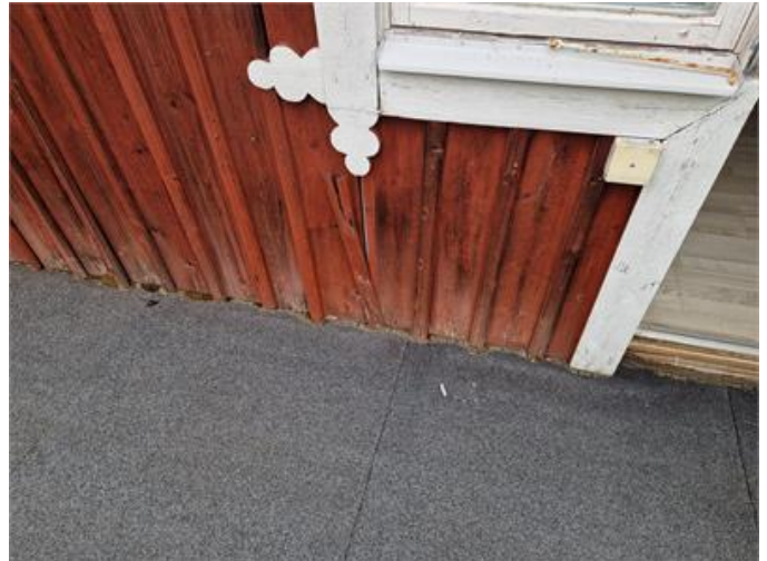
Tak: Anslutning mellan tak på burspråk och fasad bör kontrolleras och eventuellt åtgärdas.
