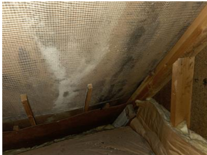
Mikrobiell påväxt samt fuktfläckar på underlagstak.
