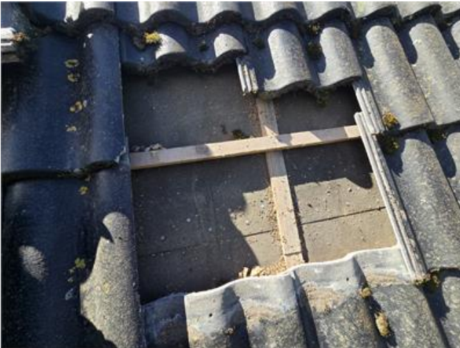
Tak: Stickprovskontroll under pannor, äldre underlagspapp med tunna ströläkt noteras lokalt.
