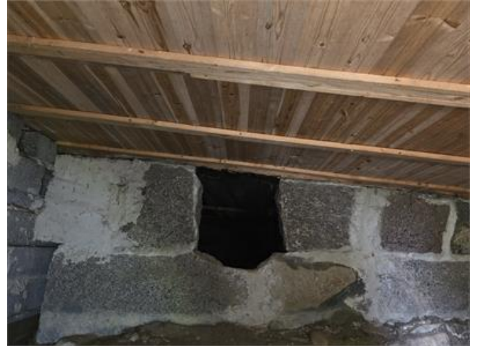
Krypgrund tillbyggnad: Översiktsbild, yttlig mikrobiell påväxt lokalt på blindbotten.
