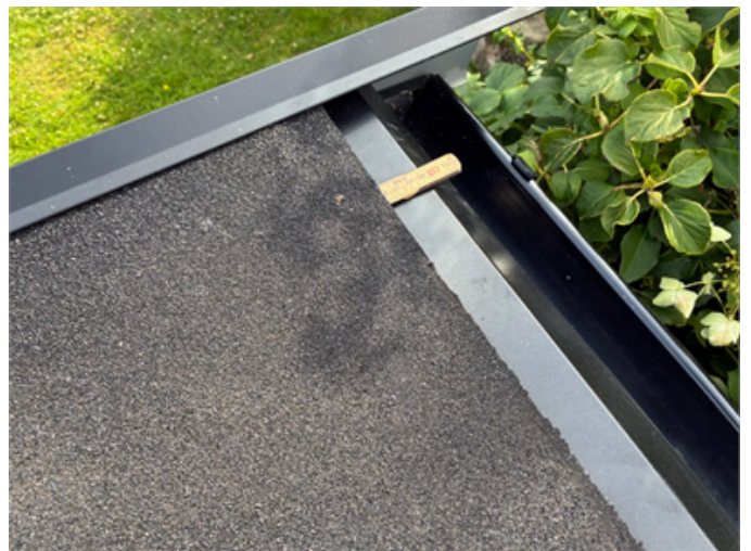
Tak garage: Exempel på otätheter i garagedelens taktäckning.
