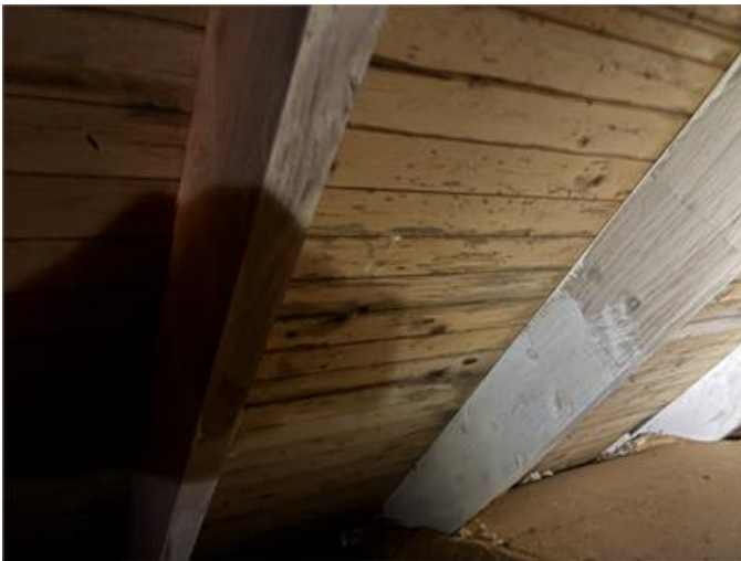
Nockvind: Mikrobiell påväxt finns på underlagstaket.
