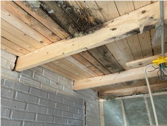
Bilden visar skador i underlagstak i groventré.
