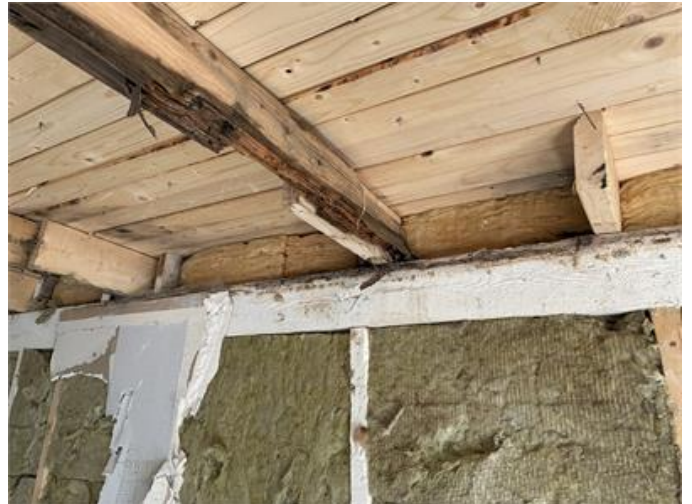
Luftning finns ej mellan isolering och underlagstak ovan garage.
