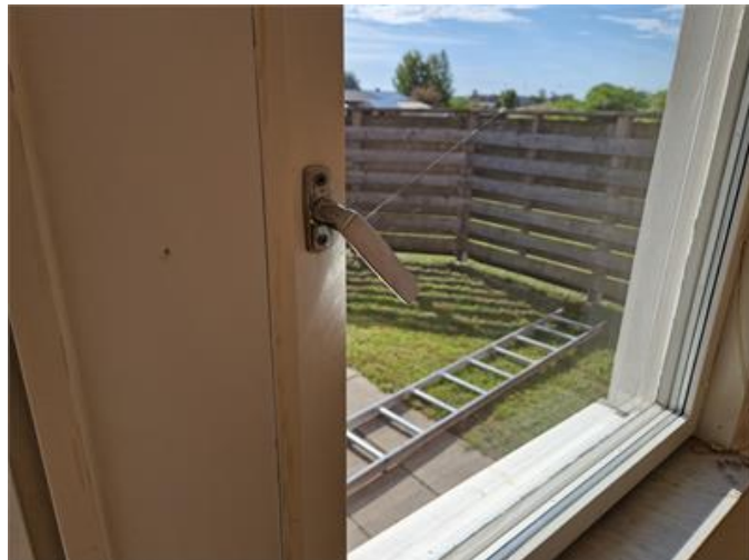
Kök: Fönsterstängning fungerar ej helt.
