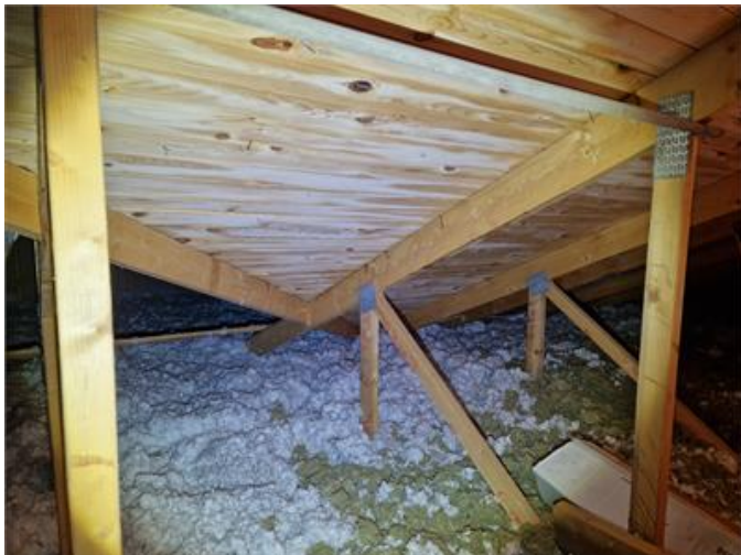
Vind: Mikrobiell påväxt förekommer på underlagstakets undersida
