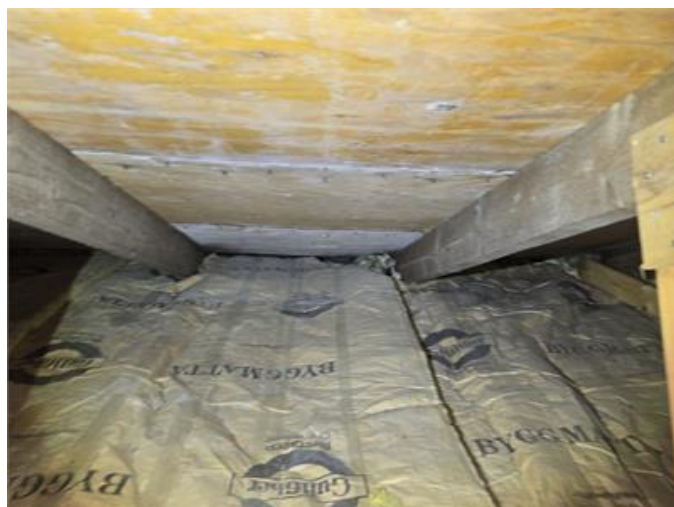
Nockvind: Exempelbild på yttlig mikrobiell påväxt samt isolering som ligger an mot underlagstak.
