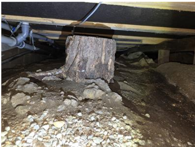
Krypgrund: Stubbe noterades i utrymmet.
