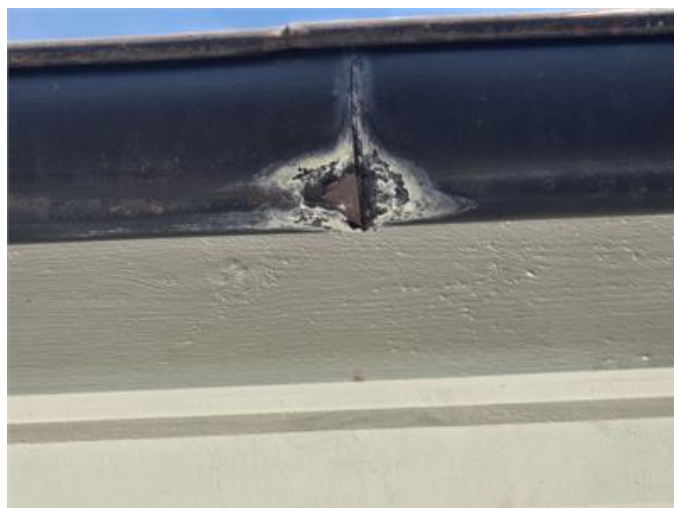
Rännor: Läckage noteras i rännskarv.
