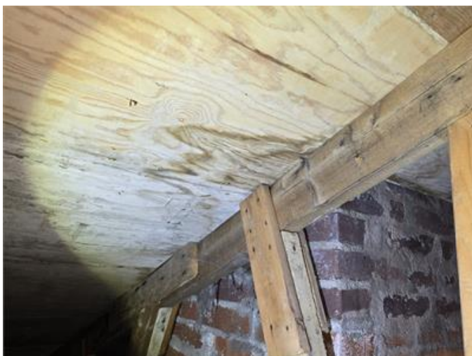
Nockvind: Fuktanvisning intill murstock.
