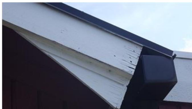
Bilden visar rötskada i vindskiva
