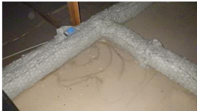
Fuktfleck på vindsgolvet
