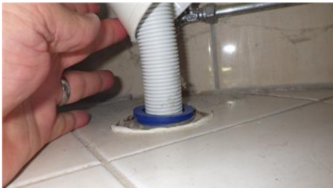
Bild visar avloppsstos som inte är uppdragen över golvnivå
