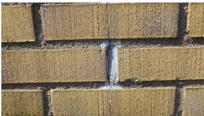
Bilden visar spricka i fasadteglet
