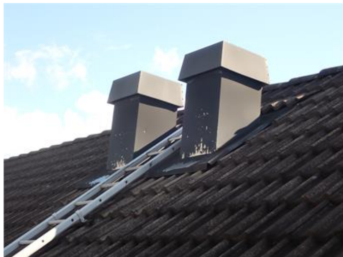
Exempel på färgsläpp på plåtdetalj tak.
