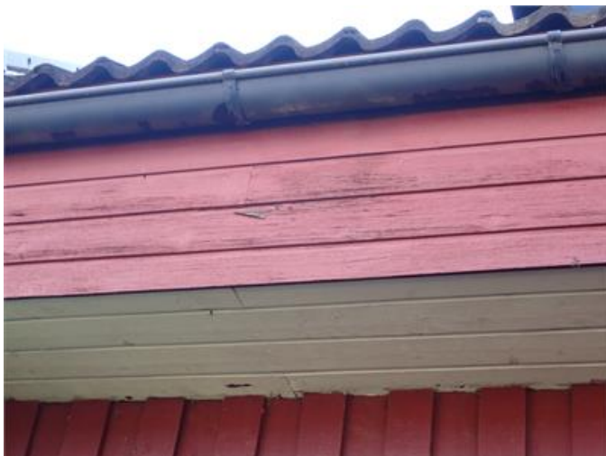
Ytlig rötskada taksarg framsida.
