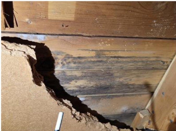
Mikrobiell påväxt samt missfärgningar
