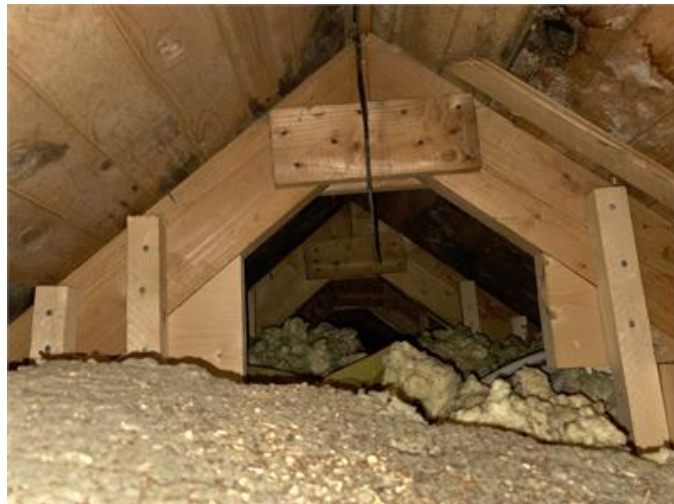
Mikrobiell påväxt samt missfärgningar
