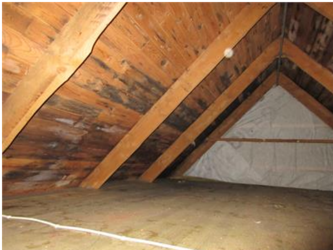
Påväxt samt missfärgning på yttertak i vind
