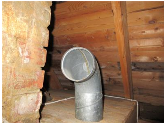
Ventilationsrör avslutas på vind
