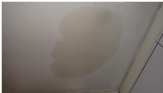
Missfärgning i innertaket på toaletten
