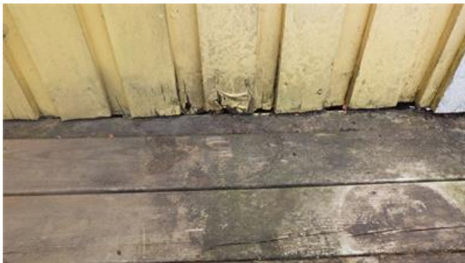
Exempel på rötskadad fasadpanel
