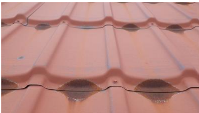
Rostfläckar på takplåten
