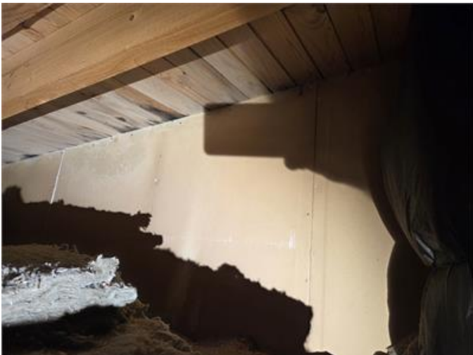
Fuktfläckar på underlagstak.
