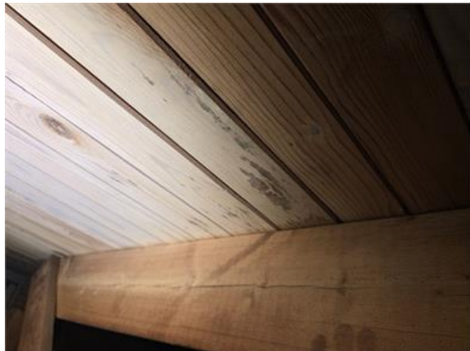
Mikrobiell påväxt på underlagstak.
