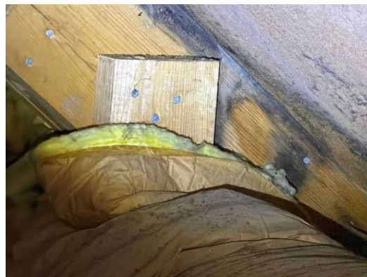
Bild 24: Info 16 - Invändigt vän 2, Vind, Tecken på inträngande vatten på några takstolar, vidare utredning krävs
