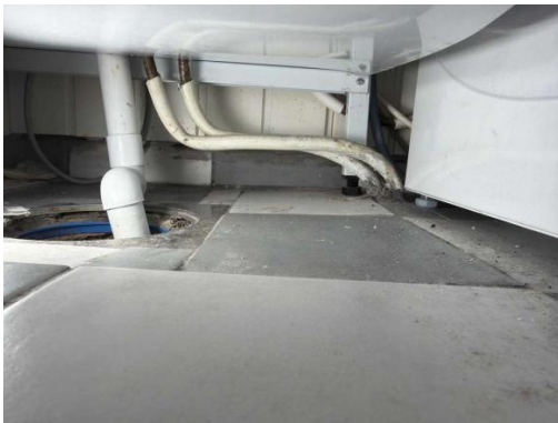
Bild 9 : Info 6 - Invändigt, Tvättstuga, Vattenrör ur golv, riskkonstruktion
