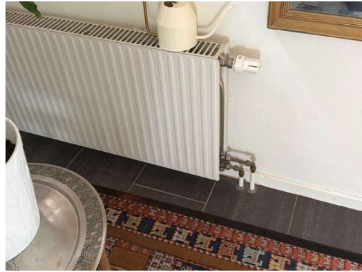
Bild 2: Not 1 - Invändigt, Entré, Vattenburen radiator och delvis golvvärme i entre
