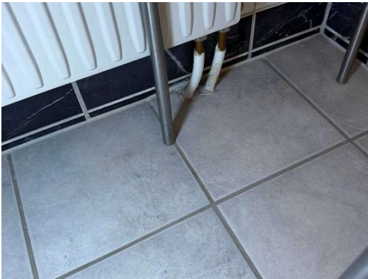
Bild 13: Info10 - Invändigt, Badrum, Radiatorrör ur golv, riskkonstruktion
