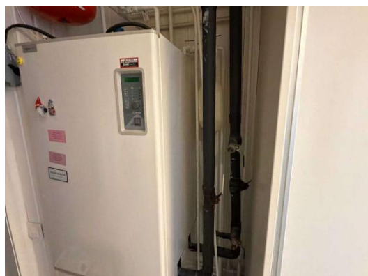
Bild 6: Info 4 - Invändigt, Tvättstuga, Skvallerrör från säkerhetsventiler saknar infästning och går ej till golvbrunn
