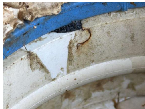
Bild 12 : Info 9 - Invändigt, Badrum, Manschett syns under klämring, felaktigt monterat tätskikt/ brunnsmanschett
