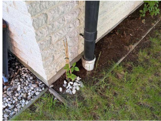
Bild 26: Info 18 - Utsida, Fasad, Saknas lövrens på stuprör, risk att dagvattenledning sätts igen
