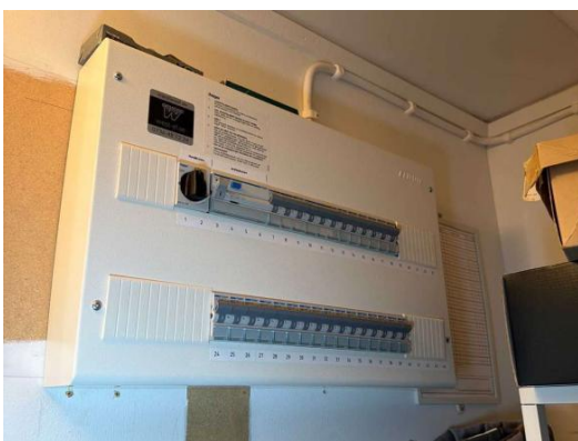
Bild 21: Not 7 - Invändigt vän 2, Klk, Elcentral med jordfelsbrytare
