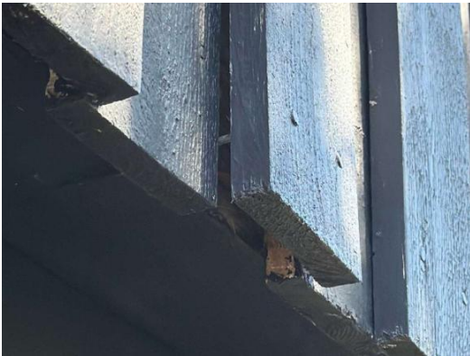
Bild 25: Info 17- Utsida, Fasad, Enstaka fasadbräda har lossa
