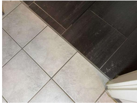
Bild 14: Info 11 - Invändigt, Badrum, Tätskikt felaktigt monterat mot tröskel/ karm, enligt dagens krav, riskkonstruktion
