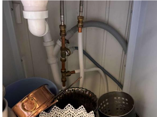
Bild 8 : Info 5 - Invändigt, Tvättstuga, Bristfällig förankring tappvattenrör
