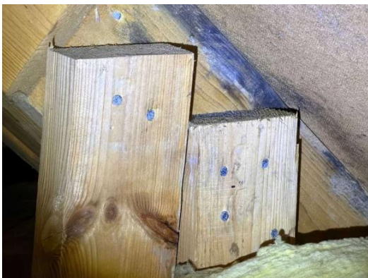
Bild 23: Info 15 - Invändigt vän 2, Vind, Tecken på inträngande vatten på några takstolar, vidare utredning krävs
