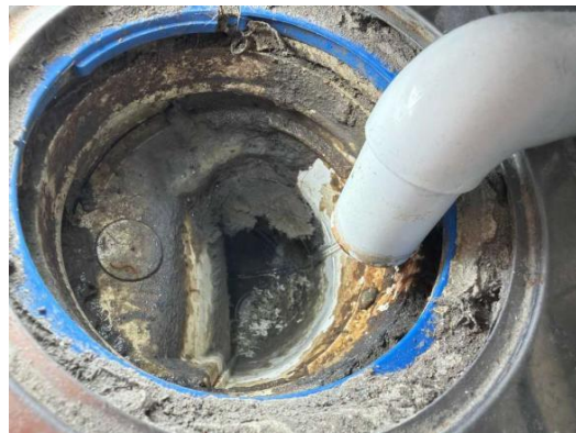
Bild 10: Info 7 - Invändigt, Tvättstuga, Golvbrunn behöver rengöras
