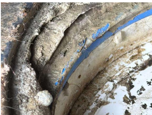
Bild 17 : Info 13 - Invändigt vån 2, Badrum 2, Tätskikt felaktigt monterat vid golvbrunnen folie/ brunnsmanschett går ej ner bakom klämring
