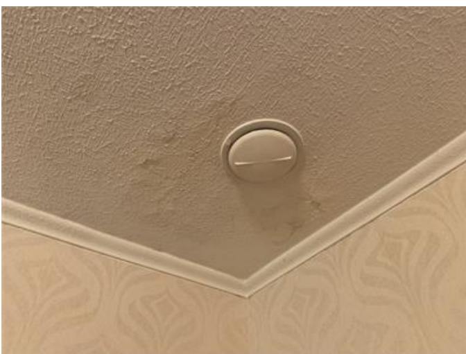
Mindre missfärgning och färgsläpp vid ventilationskanal i sovrum 1.
