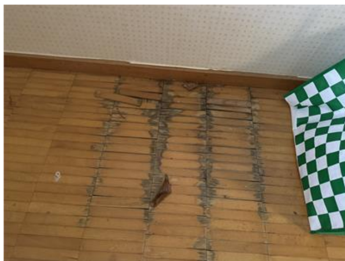
Fuktskadat golv i sovrum 2.
