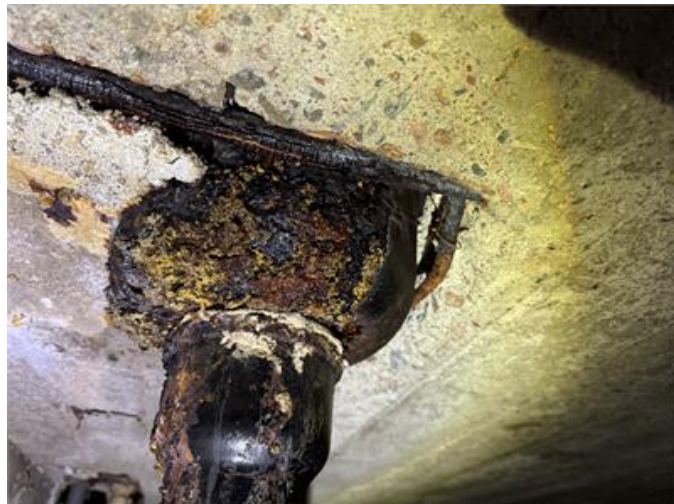
Rostangrepp på golvbrunn i garage, fotograferat underifrån.
