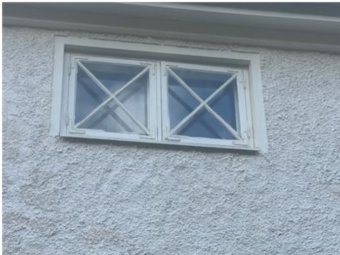
Fönster som bitvis är i behov av målning/underhåll.
