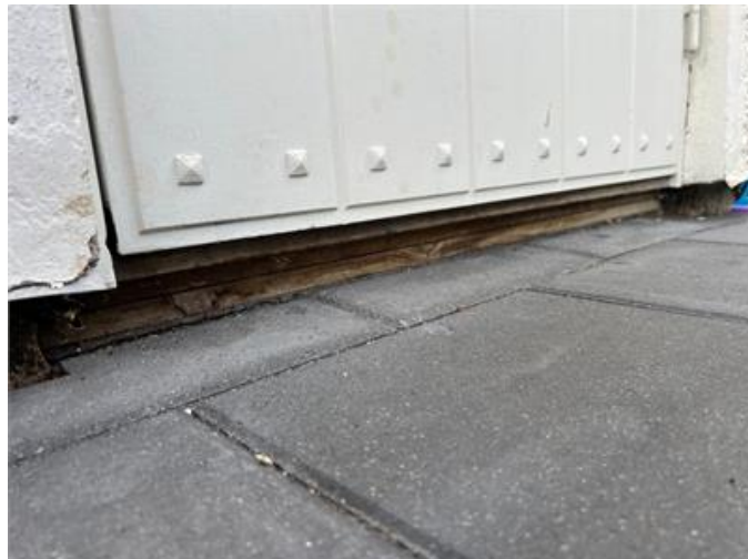
Tröskelplåt finns ej monterad på ytterdörr.
