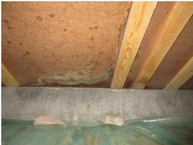
Missfärgning på undersida bjälklag under sovrum
