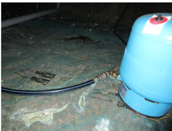
Vattenpölar på plastfolie i grund
