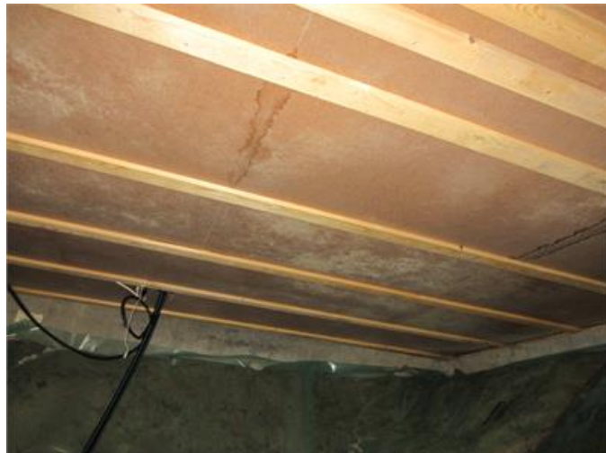
Missfärgning samt mikrobiell påväxt undersida bjälklag under tvättstuga
