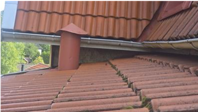
Del av fasad saknas ovan tillbyggnad tvättstuga.
