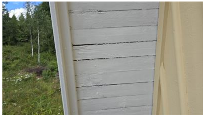
Lokal rötskada, underlagstak. Vy från balkong.
