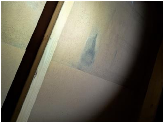
Spår av fuktinträngning och mikrobiell tillväxt.
