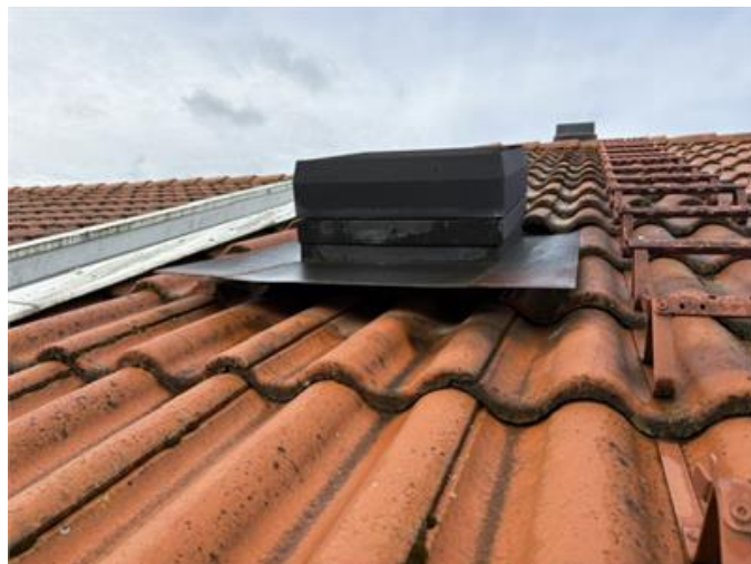
Bilden visar exempel på brister vid/med plåtdetalj.
