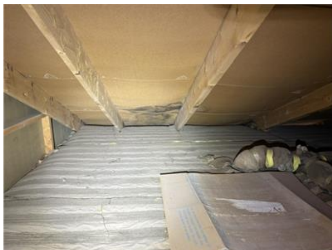
Bilden visar exempel på missfärgning (vind).
