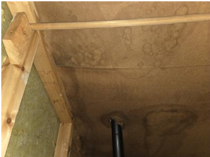
Missfärgningar på underlagstak.
