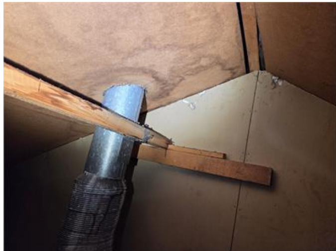
Missfärgningar på underlagstak.
