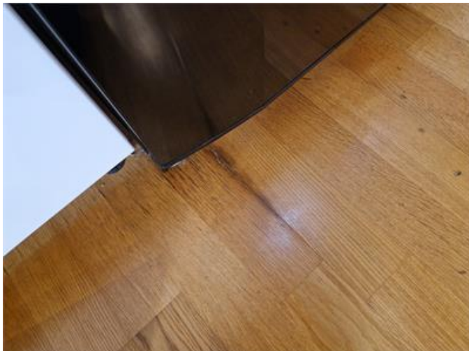
Kök: Missfärgning/fuktfläkt finns i parkett framför kyl/frys.
