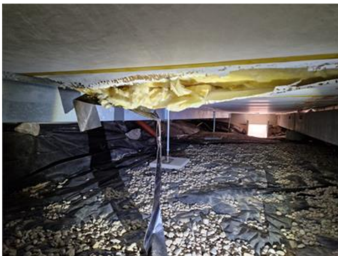
Krypgrund: Duk i blindbotten har släppt lokalt och bör justeras.
