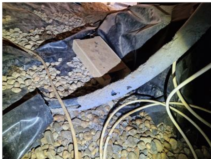
Krypgrund: Bristfällig isolering förekommer på vattenrör.
