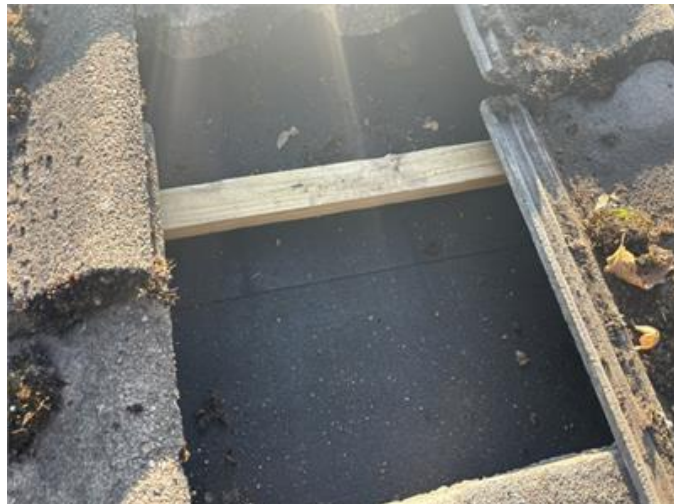
Bilden visar exempel på underlagspapp/läkt som bedöms vara utbytt.
