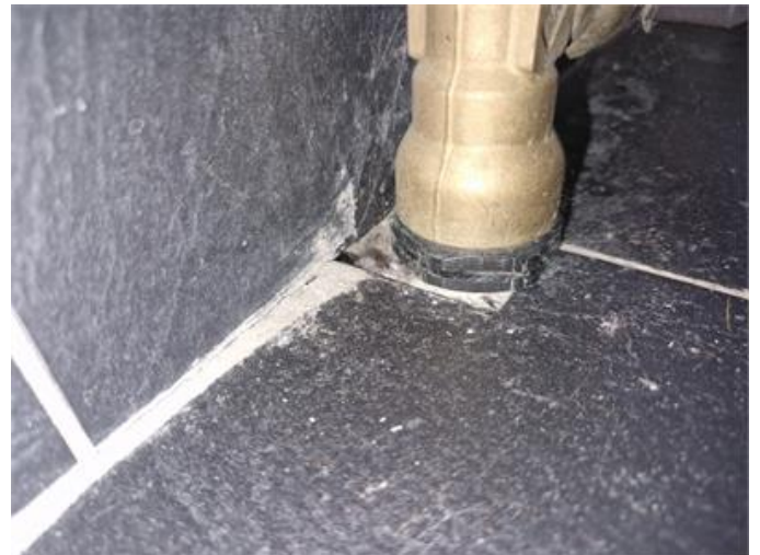
Rör genomföring är vägg nära.
