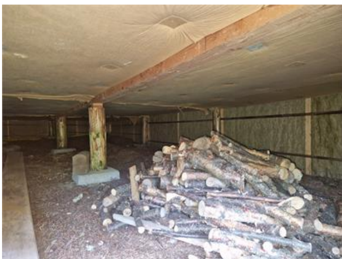
Plintgrund, ved förvaras under hus, bör flyttas.
