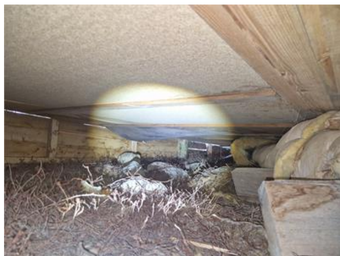
Trossbottenskiva under badrum är missfärgad och hänger.
