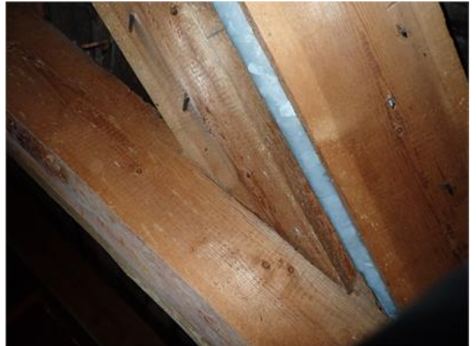
Rännal som saknar underliggande kondensskydd.
