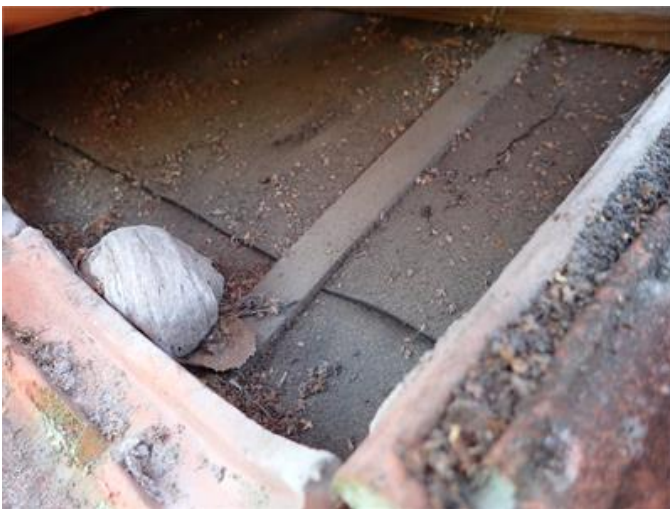
Spröd och torrsprucken takapp.
