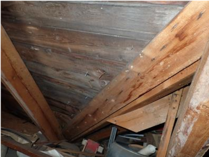
Exempel på fuktfläck på underlagstak vind.
