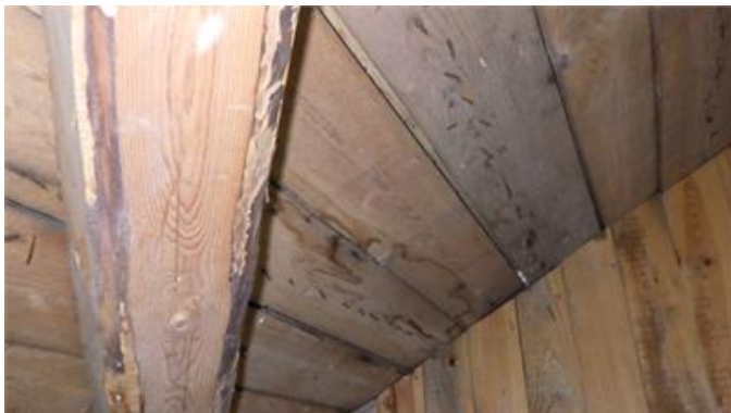
Missfärgningar på underlagstak förråd övre plan.
