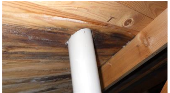
Missfärgningar vid avloppsluftare inockvind.
