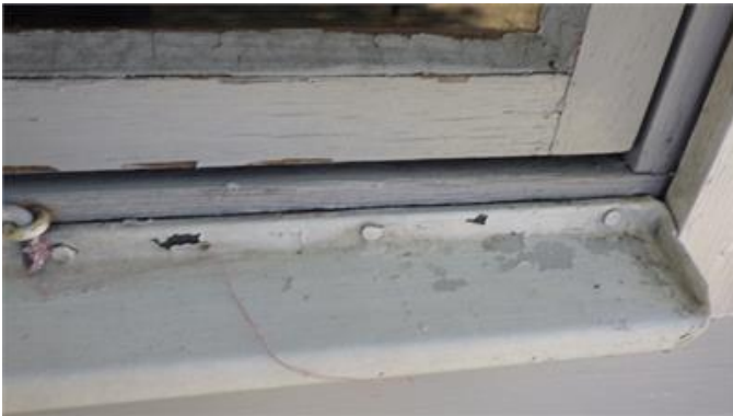
Otättheter vid fönster.
