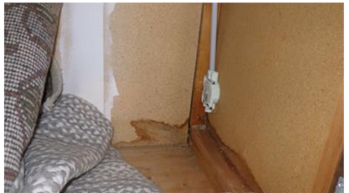
Missfärgningar i garderob som vetter mot våtrum.
