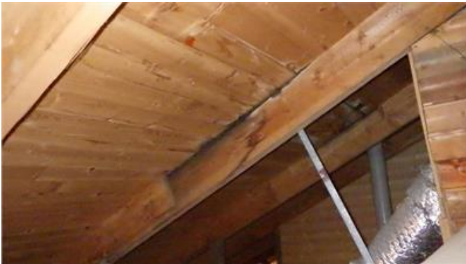
Fuktfläck på sidovind
