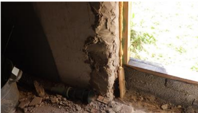
Källardörr där det inte är färdigställt runt dörren
