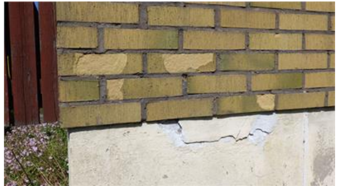
Sprickor i sockel samt frostsprängning i tegelfasaden
