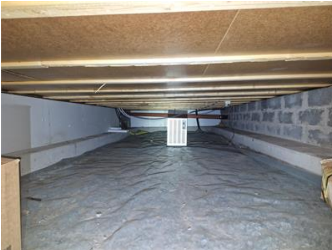
Krypgrund, kondensavfuktare placerad i norra delen
