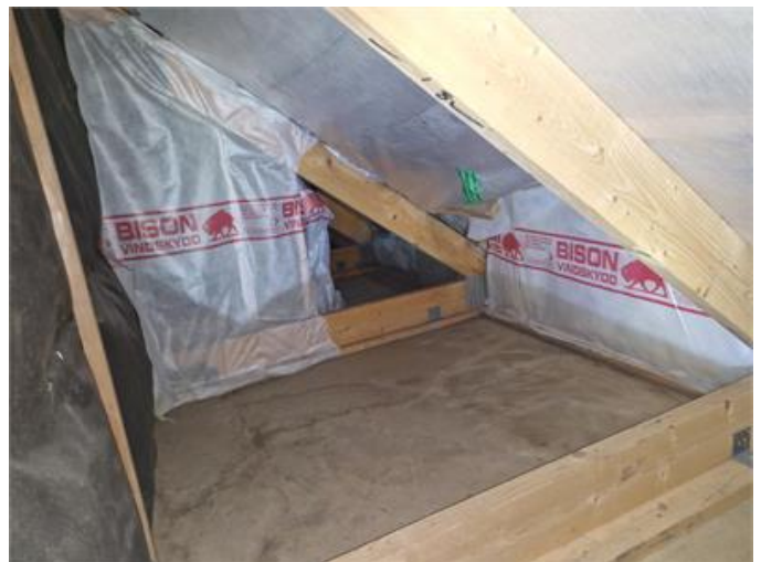
Sidovindar, torra fuktanvisningar på golvytan/masoniten.
