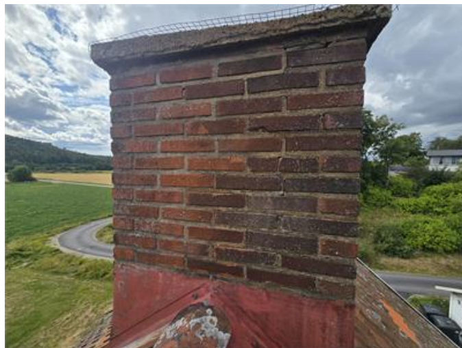
Tak: Sprickor förekommer i skorsten, väderskydd finns ej.
