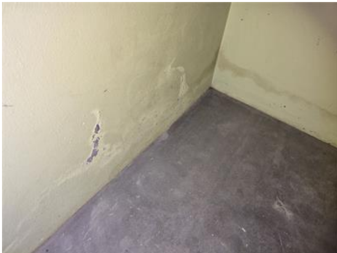
Källarfe: Exempelbild på fuktanvisningar/putssläpp i nederkant grundmur.
