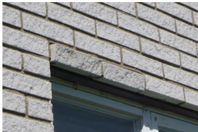
Enstaka lösa tegelstenar ovan fönster
