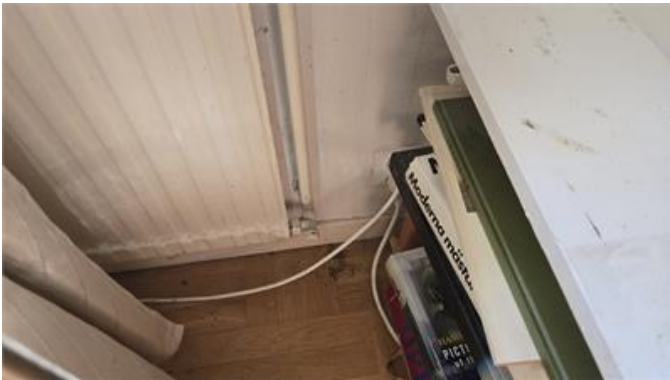
Exempelbild, fuktfläck på golv under radiator/radiatorventil.
