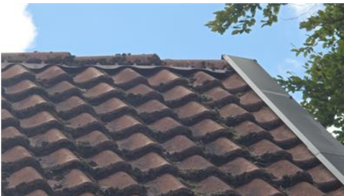
Exempelbild, bristfälligt montage av nocktätning, yttertak.
