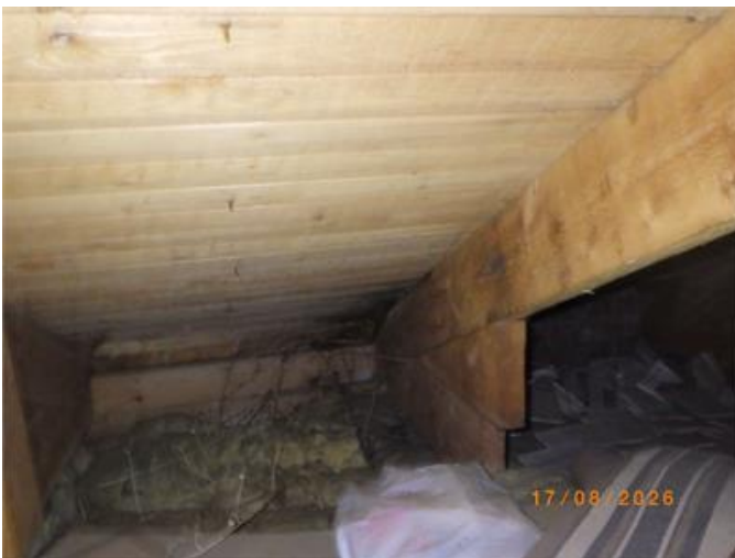
Missfärgningar noterades vid skorsten.
