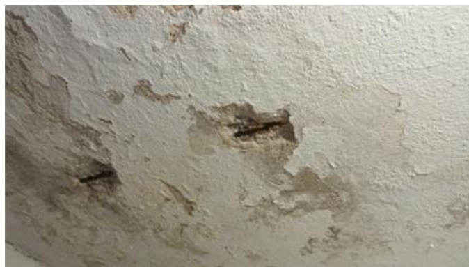
Synlig armering i tak i groventré i källare.
