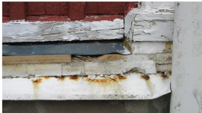
Altan i behov av renovering.
