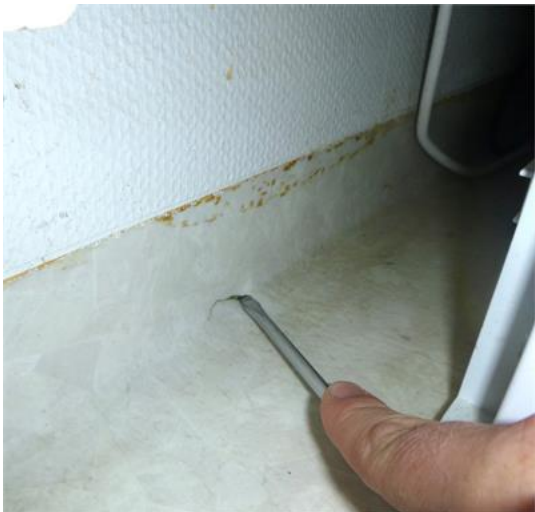
Skada i golvmattan i tvättstugan
