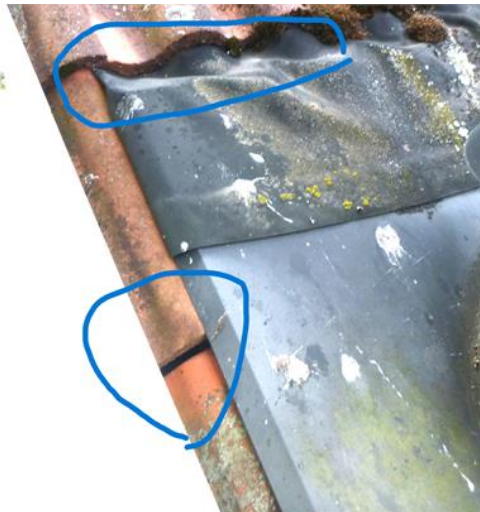
Kort brant överlapp på matta mot skorstensplåt samt lös nergliden takpanna under plåt
