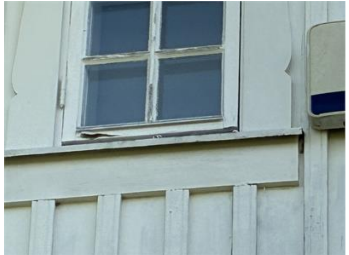
Fönster: Äldre fönster har underhåll och målningsbehov.
