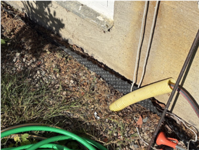
Sockel: Kantlist finns ej monterad på fuktskyddsmatta.
