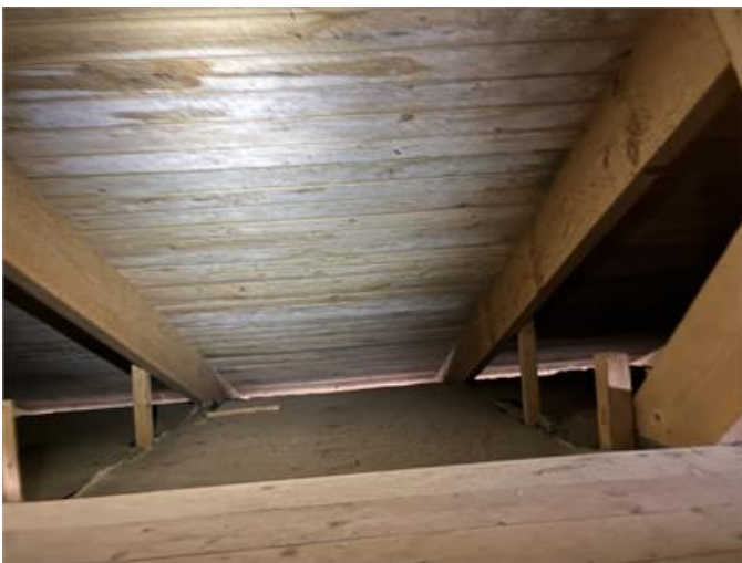
Nockvind: Mikrobiell påväxt noterades på underlagstaket.
