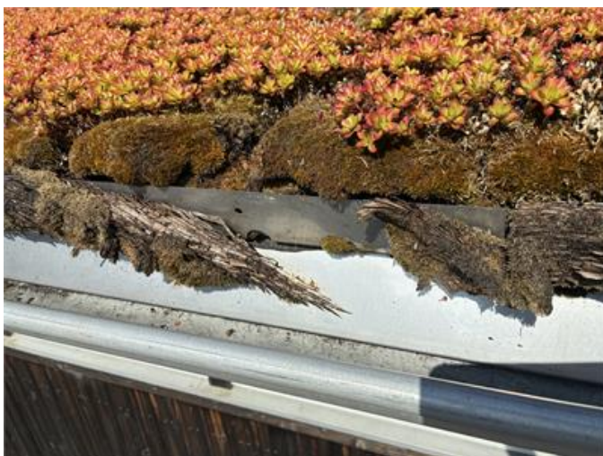
Tak: Bilden visar rötskadat täckbräda framtill på sedumtaket.
