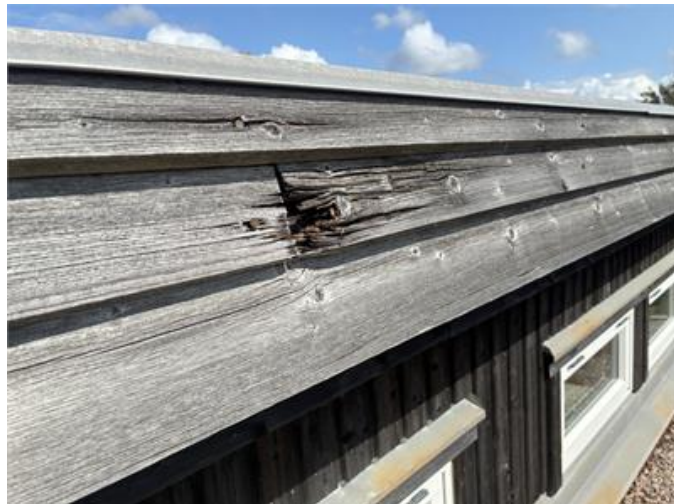
Tak: Exempel på vindskivor som har behov är byte.
