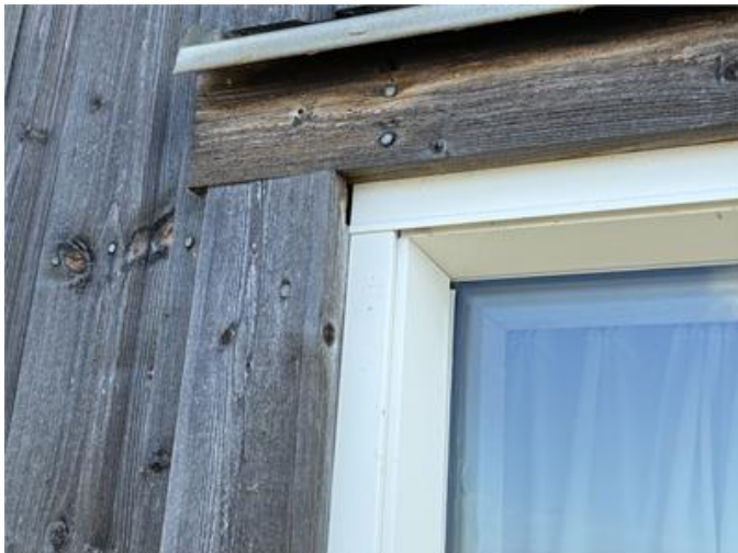
Fasad: Exempel på otäthet mellan fönster och fasad.
