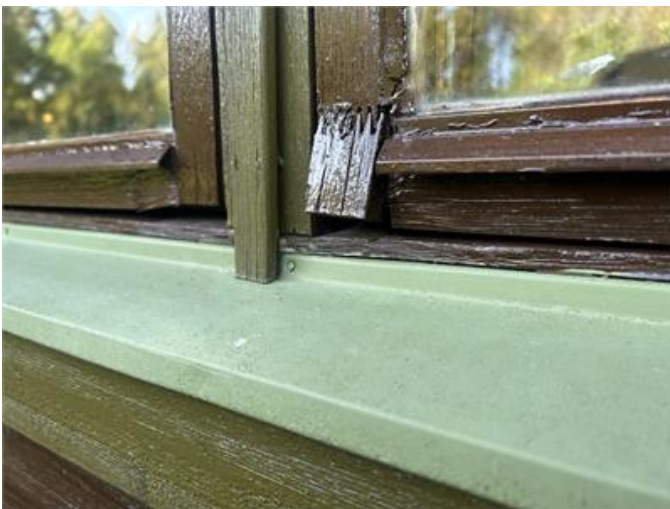
Fönster: Vissa fönster har släppt i fönster ramen.
