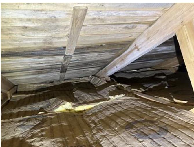
Nockvind: Fuktanvisningar och mikrobiell påväxt förekommer på underlagstaket. Torra vid besiktning.
