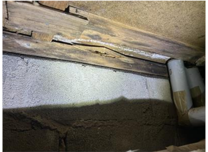
Krypgrund: Rötskador förekommer vid bl.a. södersida.
