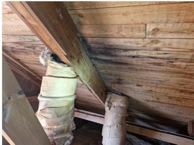
Nockvind, torra fuktanvisningar runt genomföringar.
