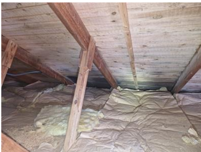
Nockvind, mikrobiell påväxt i underlagstaket ner mot vinkelutbyggnaden.
