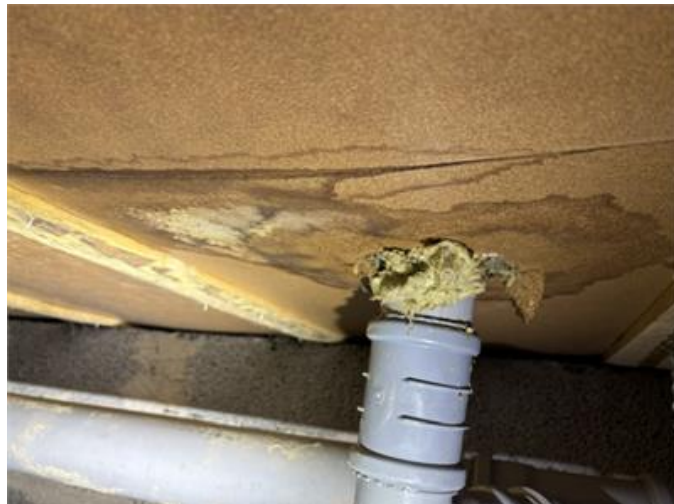
Bilden visar exempel på missfärgning i trossbottens undersida.
