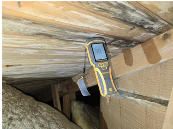
Nockvind: Fuktanvisningar i underlagstak vid murstock, torrt vid besiktning.
