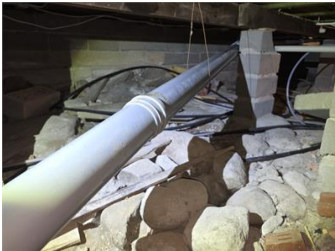
Krypgrund: Bristfälligt upphängda avloppsrör.,
