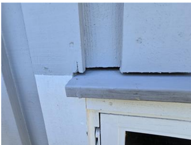
Fönster: Överbleck utan gaveluppvik, otätheter noteras.
