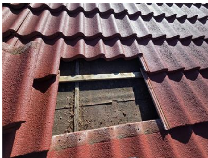
Tak: Stickprovskontroll under pannor, underlagspappen något spröd. Tunna ströläkt.
