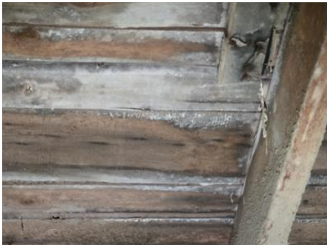
Mikrobiell påväxt på underlagstak
