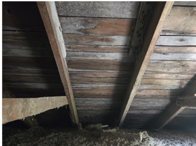
Mikrobiell påväxt på underlagstak
