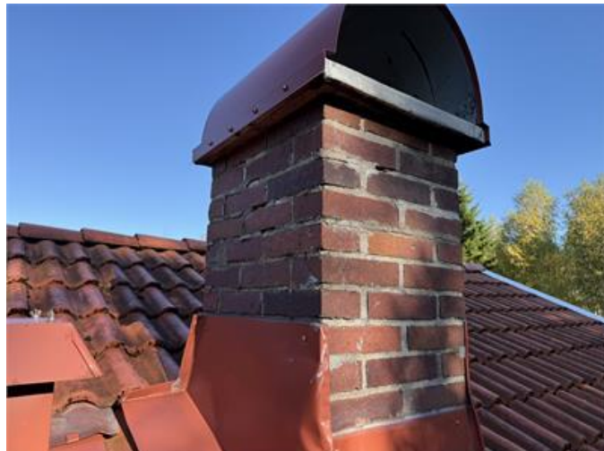
Översiktsbild skorsten med lösa fogar
