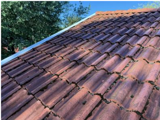
Översiktsbild yttertak med begynnande mosspåväxt
