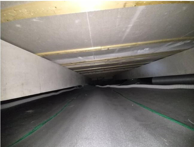
Brädor mäter förhöjd fukt men det är samma som i övrig kryppgrund på div delar.
