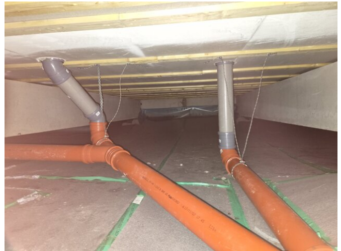
Här kommer avlopp ner från badrum. Brädor mäter förhöjd fukt men det är samma som i övrig kryppgrund.
