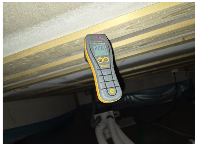
Fuktmätning i brädor på div delar i kryppgrund visar 17-22% fk. Det är för högt.
