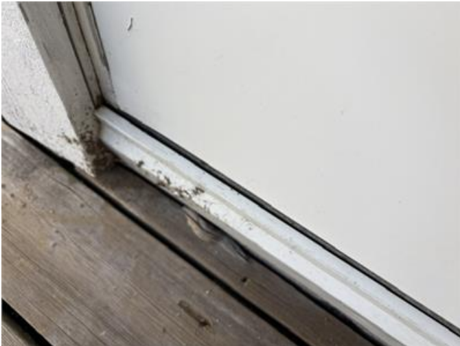
Bilden visar exempel på otätheter/brister vid/med plåtdetalj.
