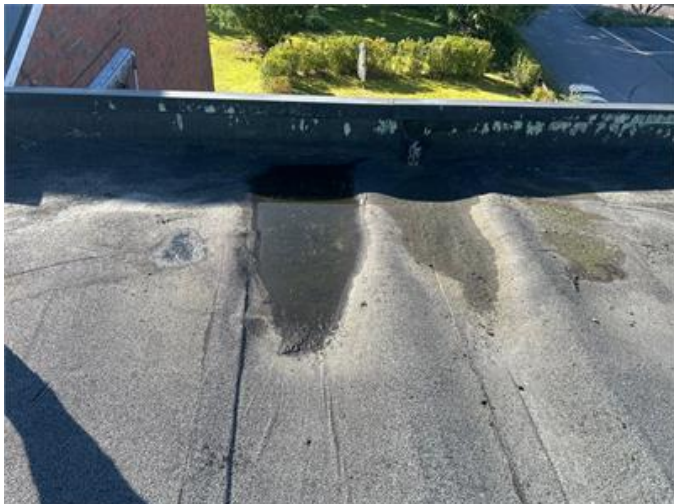
Svackor med vattenansamlingar i papptak.
