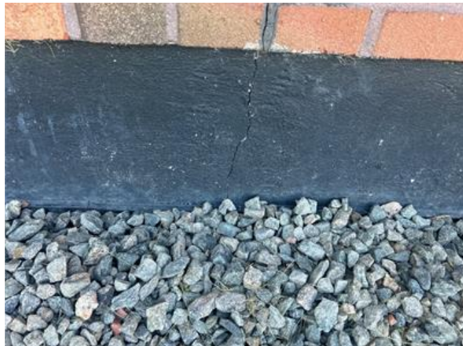
Spricka i sockel/vägg pga sättning.
